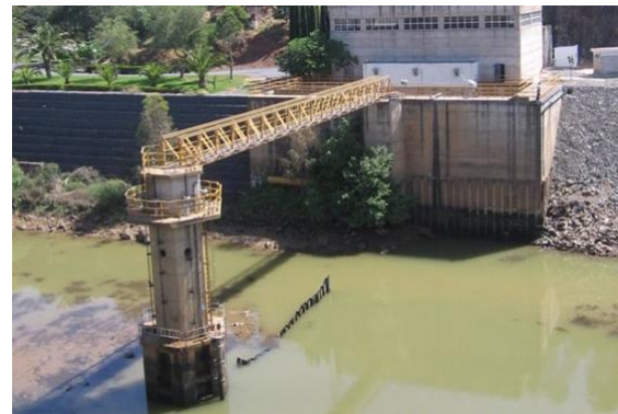
Imagen 1. Bombeo de Bocachanza, ubicado en la confluencia del río Chanza y Guadiana.
